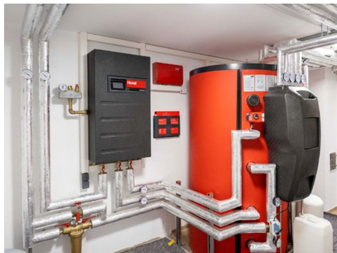
Locale tecnico perfetto: la soluzione di sistema di Hoval fa risparmiare spazio e può essere ampliata con facilità.
