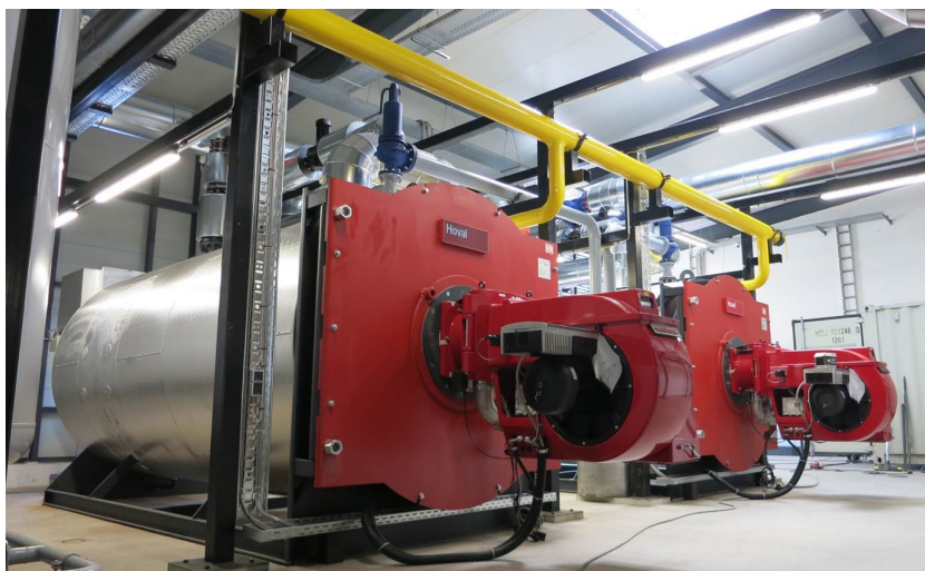
Bild 3: Die Hoval Erdgaskessel im Einsatz.
